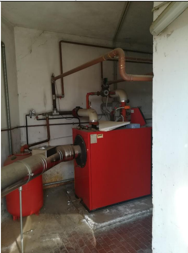
Caldaia a basamento a gas metano Riello 3500 S190 Potenza nominale 209 kW, Focolare 230 kW
